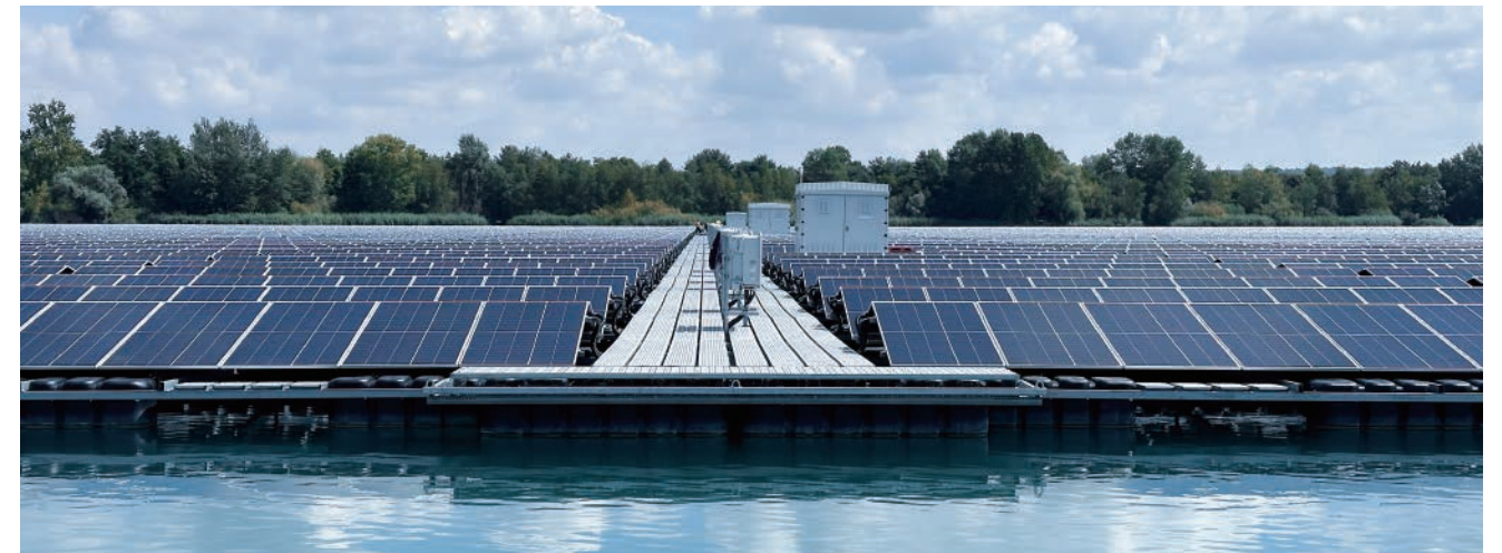
Allemagne Date de l'installation : 2024
