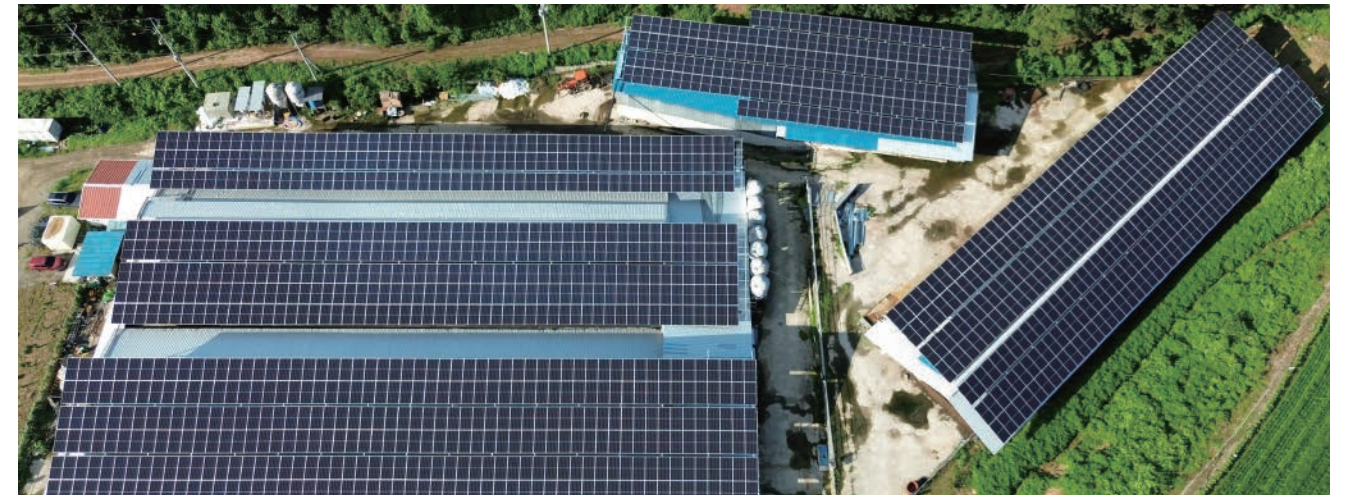
Corée Date de l'installation : 2024
